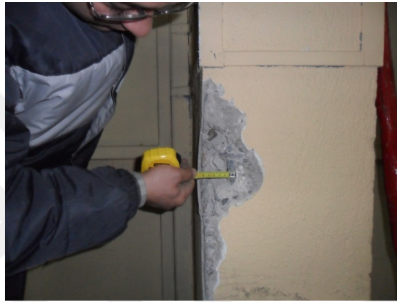
Şekil 3.4. Paspayı Sıyrılarak Betonarme Donatı Tespiti (Köken., A. Arşivi)
