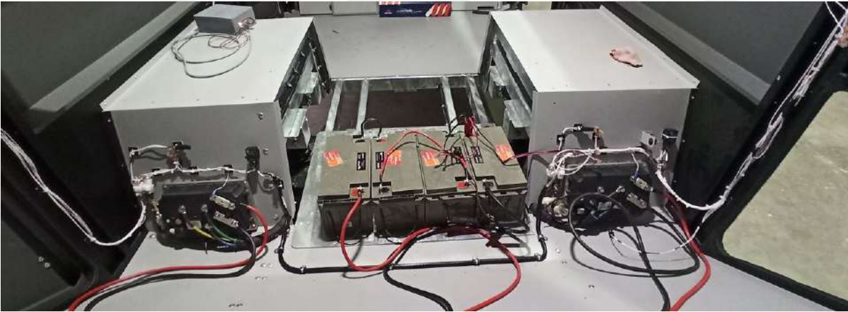
Şekil 4.4. HUB Motor Ve Elektrikli Motor Sürücüler Test
