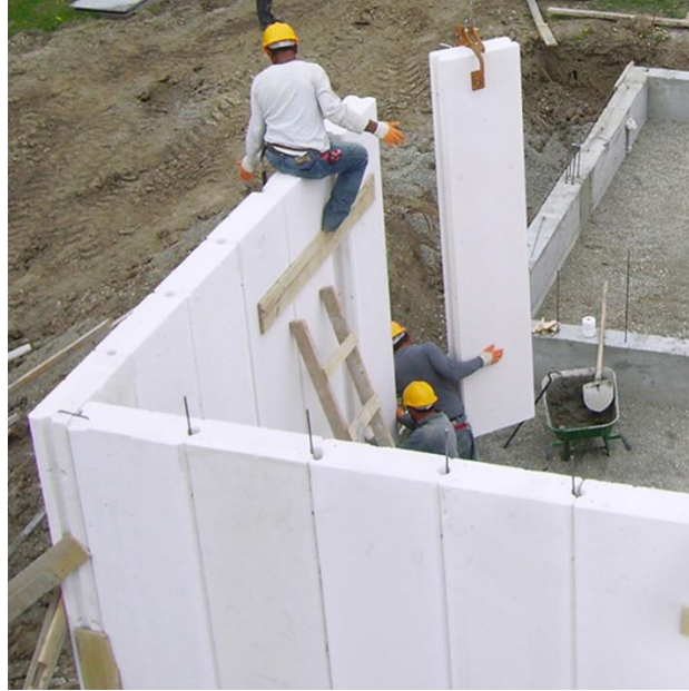
Şekil 3.9 Donatılı panel sistemli yığma bina yapımı (Web İletisi- Yığma Yapı Nedir? Yığma Bina Çeşitleri ve Özellikleri (insapedia.com) )
