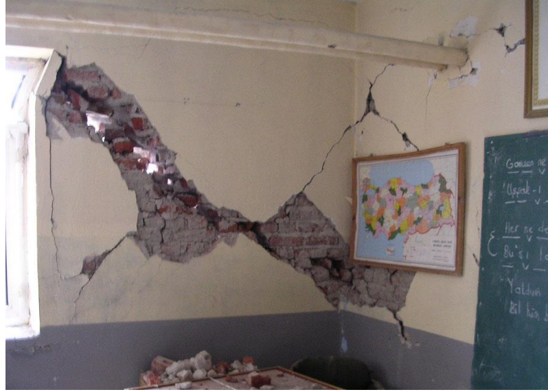
Şekil 3.31 Yığma yapıda köşe hasarı (Korkmaz, 2007)
