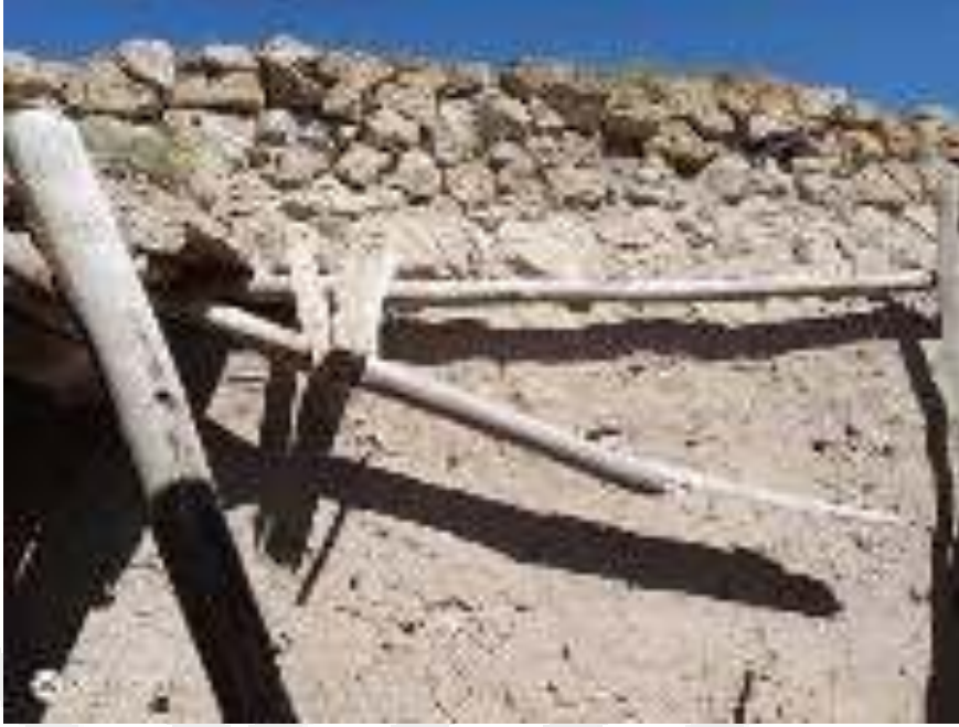
Resim 22.-23. 1 No.lu Ev Üst Katının Yıkılan Tavan Görünümleri (Ömer İçirgin)
