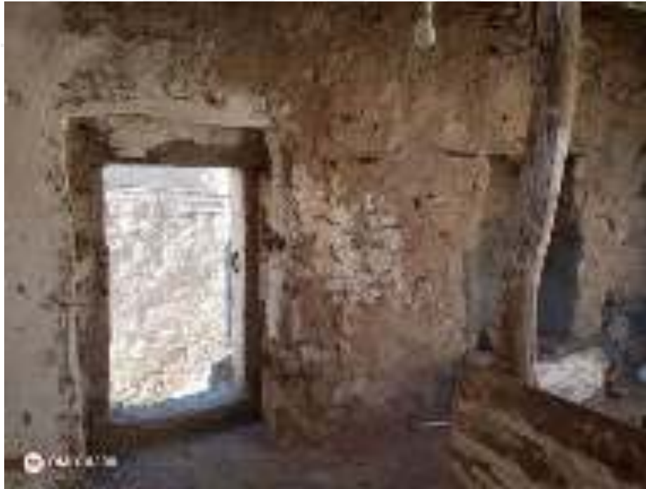
Resim 18. 1 No.lu Ev Üst Katının Sökülmüş Kapı Girişi (Ömer İçirgin)
