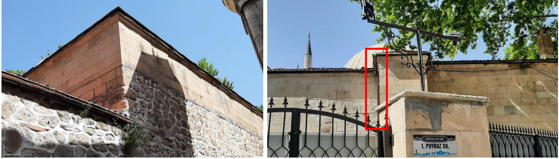
Resim 5.25. Solda saçak korniş, sağda saçak hattı ve eklenen yağmur iniş borusu
