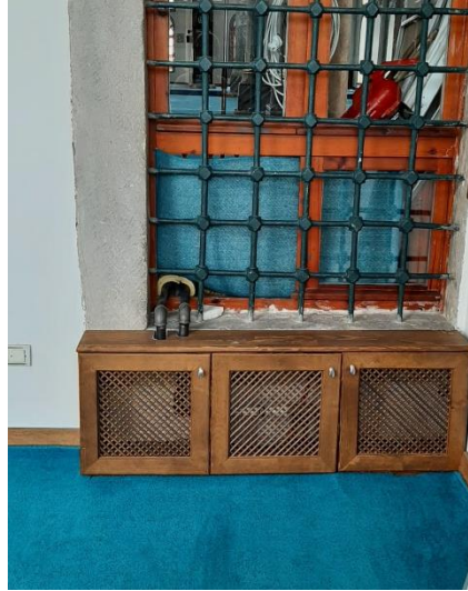
Resim 6.1. Ulu Cami'nin son cemaat yerindeki yerden ısıtma sisteminin doğalgaz kutusu ve boruları
