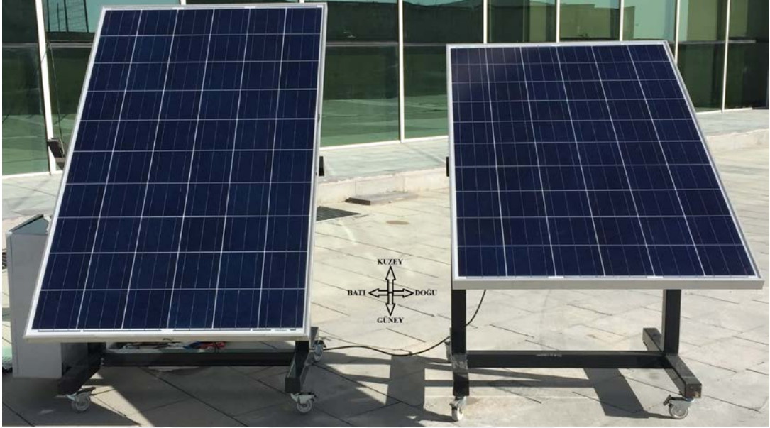
Şekil 3.10. Aynı şartlarda yan yana yerleştirilen tek eksen kuzey-güney takipli sistem (solda) ve sabit sistem (sağda)
