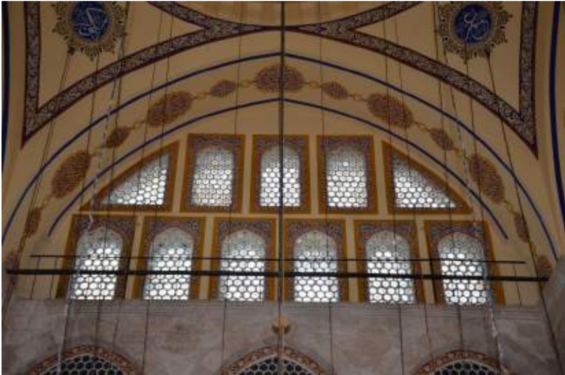
Resim 182 Kuzay duvar yüzeyindeki alçı içlikler
