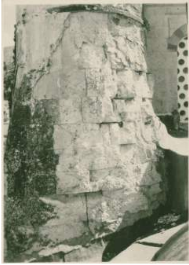
Resim 4 Minare kaidesinin hasarı 1952 (E. Akbalık)
