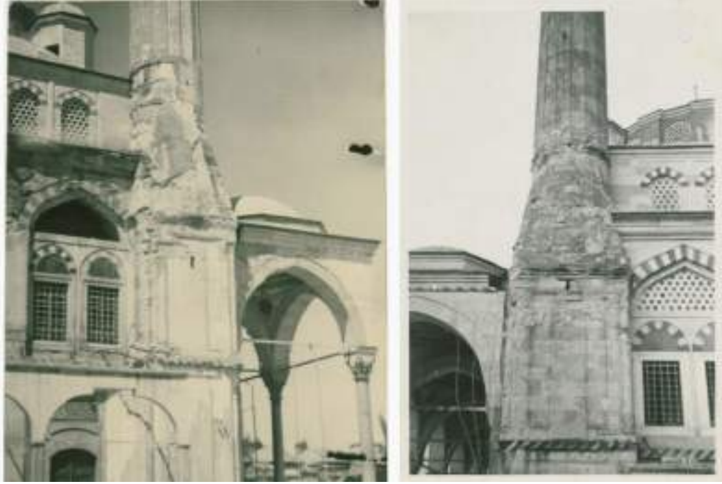
Resim 2- Minarelerdeki taş hasarı 1952 (E. Akbalık)
