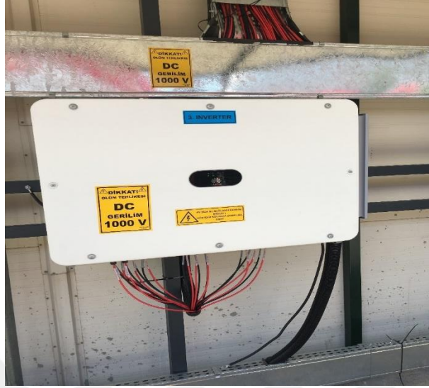
Şekil 3.13 1000 Volt invertör invertör
