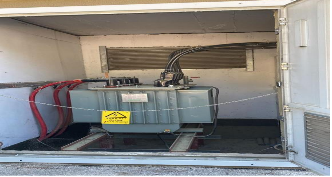
Şekil 3.23 Bina tipi trafo
