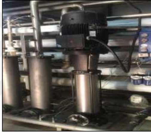
Şekil 4.10. RO Besleme Pompası
