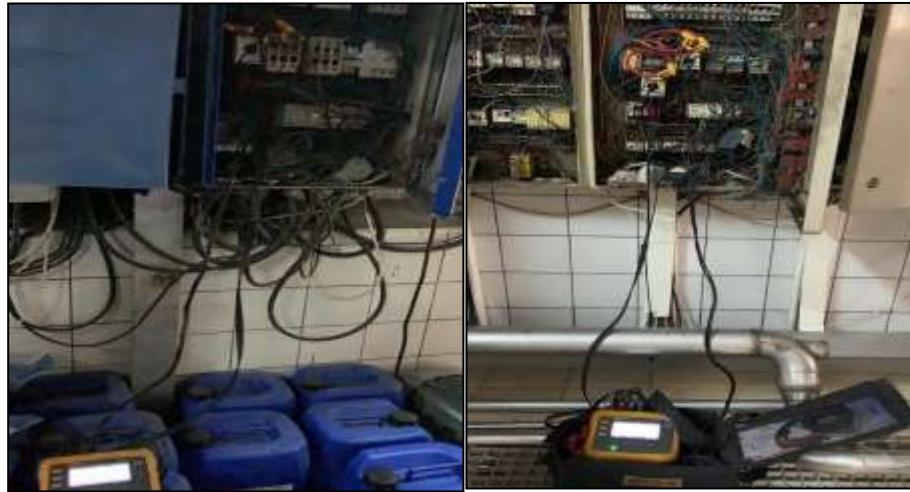
Şekil 4.14. Pompalarda enerji analizörü ile aktif güç ölçümü
