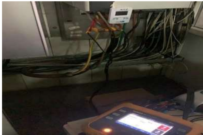
Şekil 4.7. Enerji analizörü ile elektrik motorlarında aktif güç ölçümü
