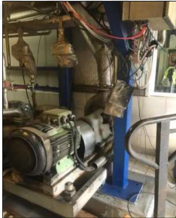
Şekil 4.12. Vakum altı soğutma kulesi pompası
