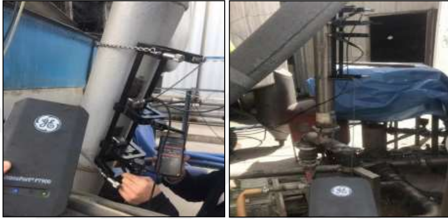
Şekil 4.13. Pompalarda ultrasonik sıvı debimetresi ile debi ölçümü
