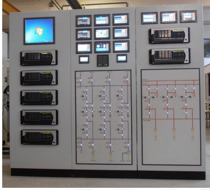
Şekil 3.4. Kontrol panosu görüntüsü (“Yüksek Gerilim Kontrol & Scada & Mimik Panosu”, 2022)
