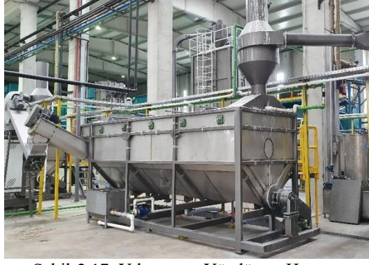
Şekil-2.17. Yıkama ve Yüzdürme Havuzu
