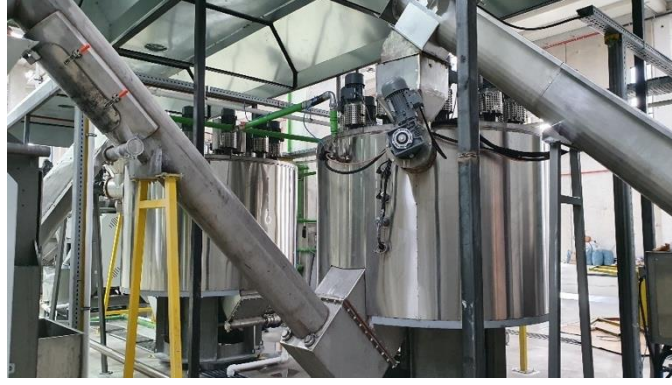
Şekil-2.19. Sıcak Yıkama Havuzu
